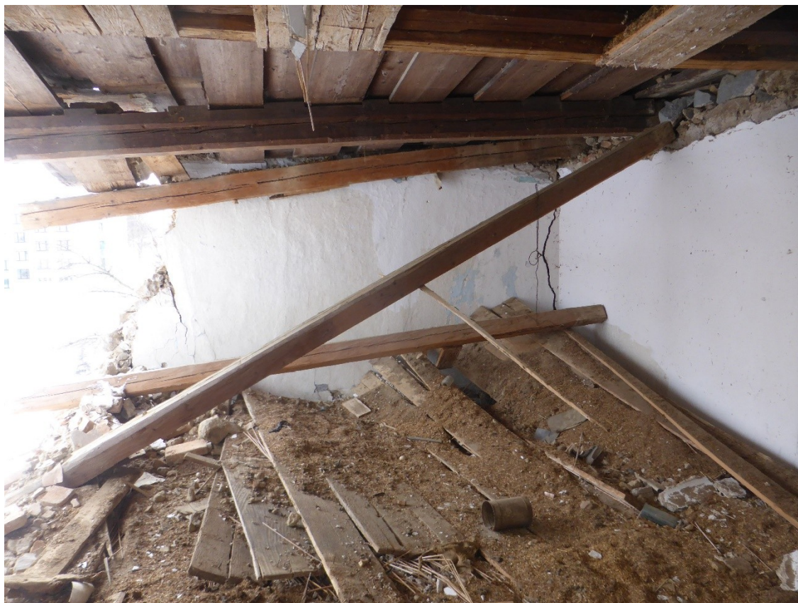
Foto 801, objekt A3, místnost 209 nad zříceným nárožím (Leden 2021)
