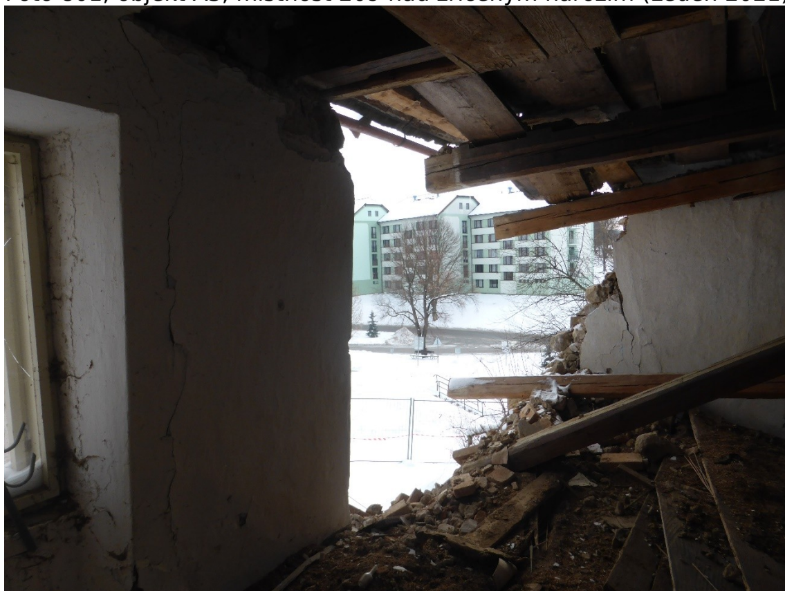
Foto 802, objekt A3, místnost 209 nad zříceným nárožím (Leden 2021)
