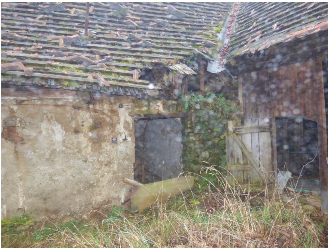
Foto 935, pohled ze dvora; trhliny, zatékání střechou a neregulovaná vegetace (Leden 2021)
